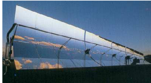
Abbildung 1.1: Parabolspiegel eines konzentrierenden solarthermischen Kraftwerks in Spanien (Quelle: SKAL-ET)
